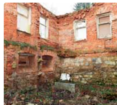
Nyní je již ve stavu, kdy jakýkoli pokus o záchranu je nemožný a hrozí nebezpečí zřícení.
