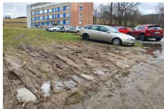
Parkovací místa a chodníky na mikulášovicckém sídlišti jsou opravdu již v krčickém stavu
